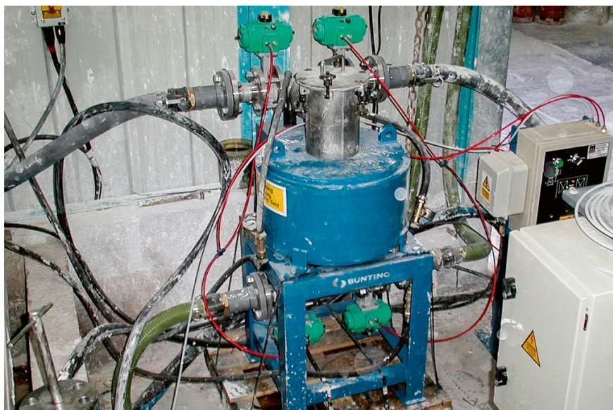
Bild 4 Elektromagnetischer Filter von Bunting in einer Produktionsanlage für Keramik (© Bunting)
